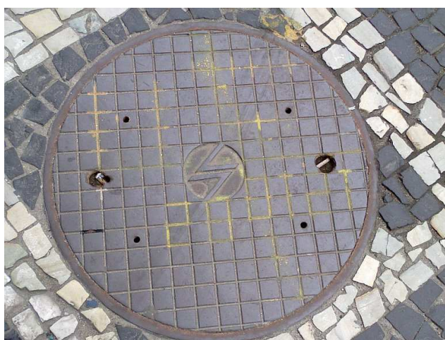
Figura 2: Buracos abertos nas tampas de caixas de inspeção.
